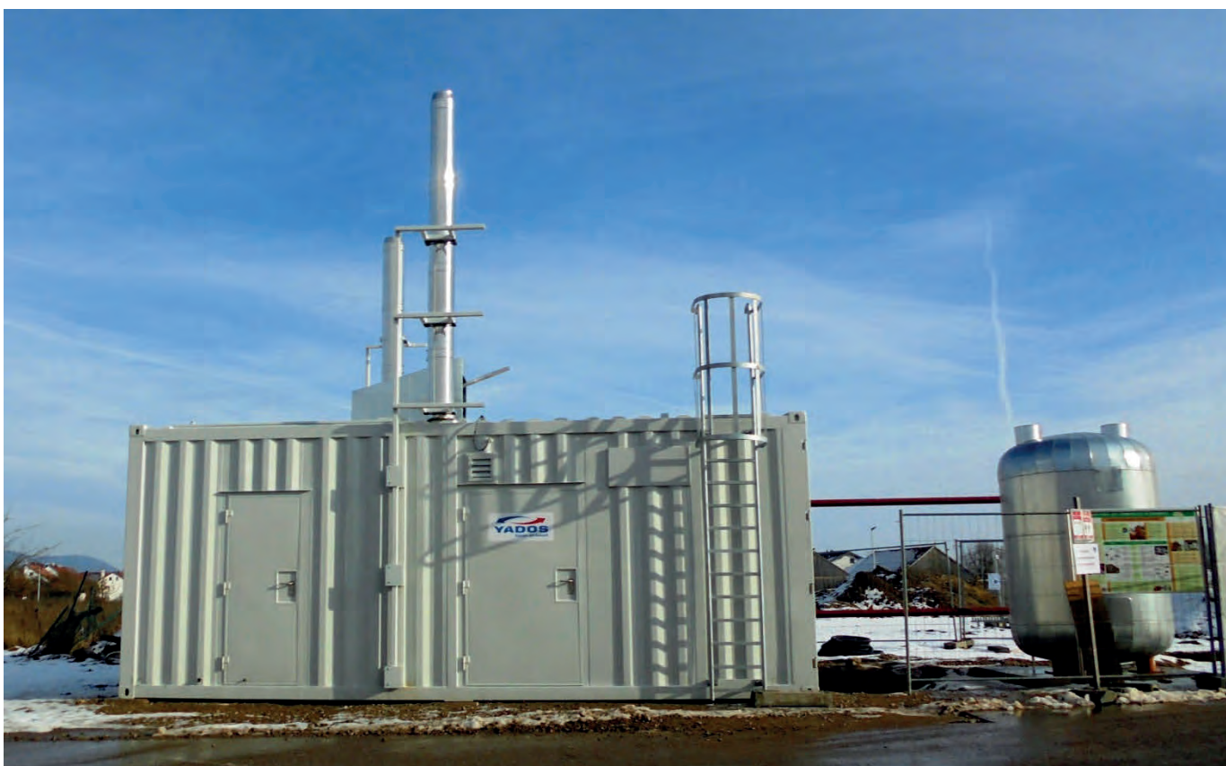
Heizwerk für das Baugebiet Süd-West: Im Dezember 2019 erfolgte der Spatenstich für das Wärmenetz und am 23. April 2020 genehmigte der Gemeinderat den Bau des Heizwerkes, das im Januar 2021 fertiggestellt wurde (Jahnstraße 28). Seit der letzten Februarwoche ist das Heizwerk in Betrieb. Mit einem Radlader wird ein Vorratsbehälter im Heizwerk mit den getrockneten Hackschnitzeln aufgefüllt.
